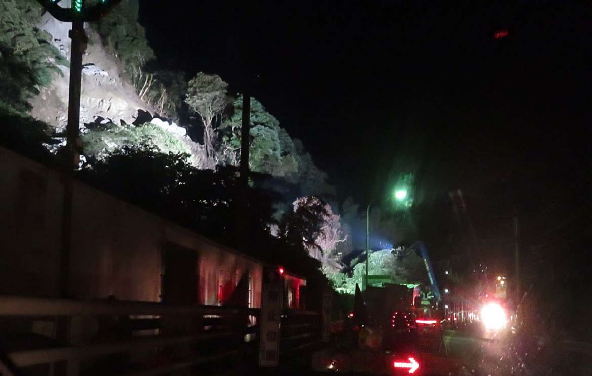
夜間片側交互通行の状況写真です。右側に照明車が確認出来ます。
